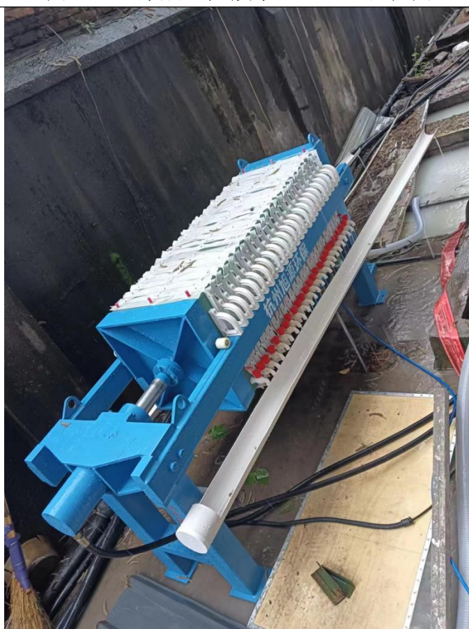
压滤机及沉淀池
