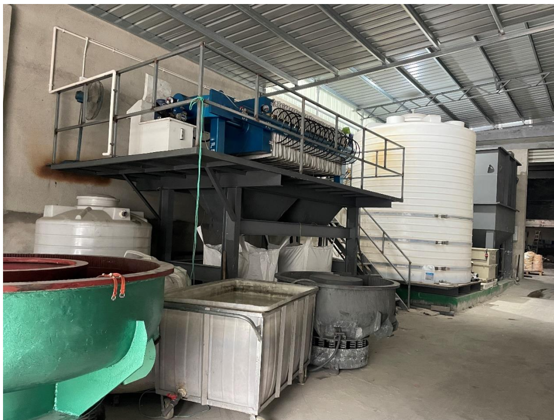
图 4.3-4 生产废水处理设施
