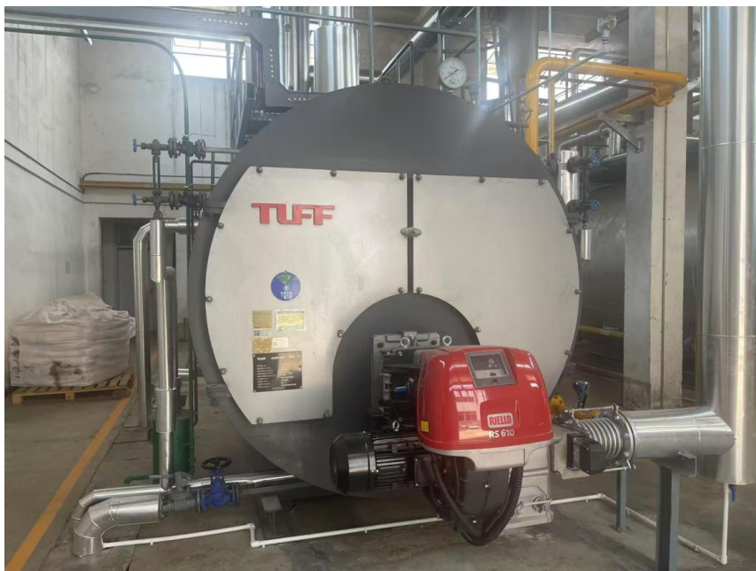
图3.1-3 DA015天然气锅炉及低氮燃烧器
