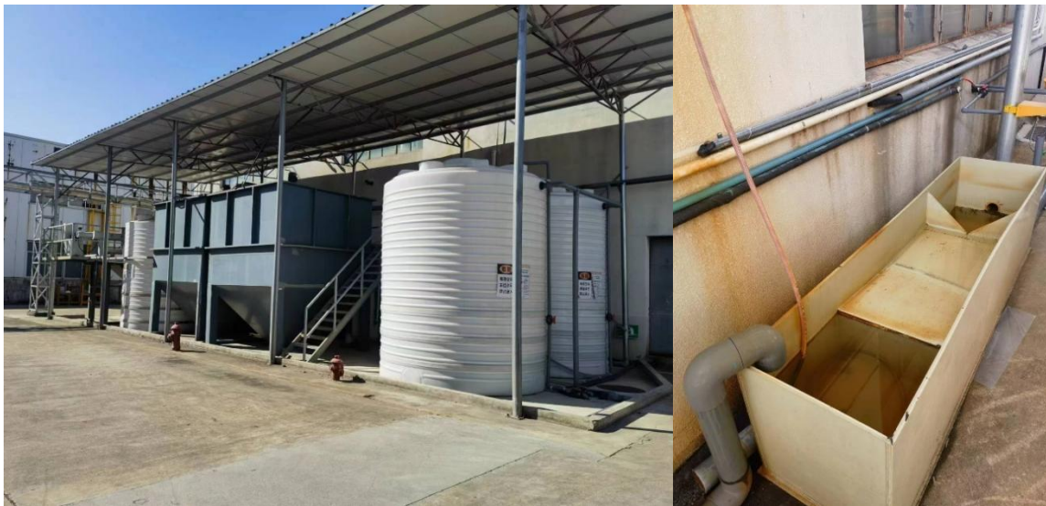
DW002生产废水处理设施
