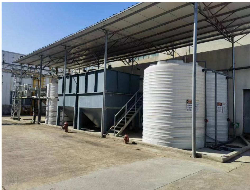
图3.1-5 生产废水治理设施照片
