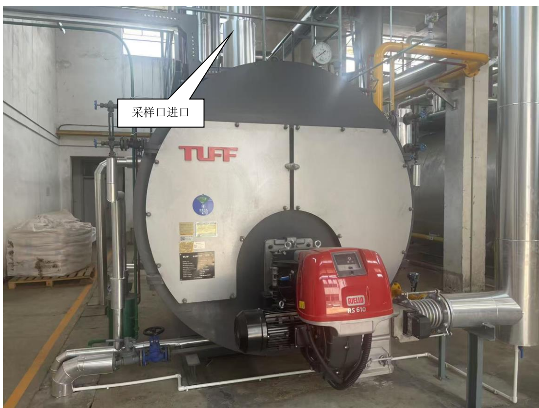
DA015废气处理设施
