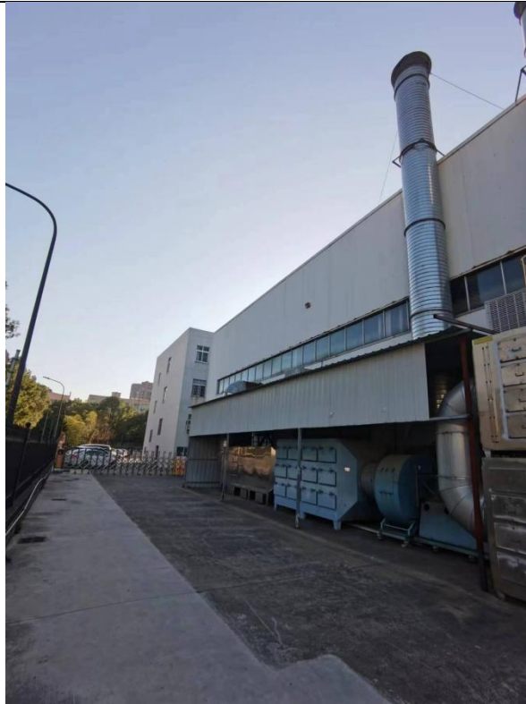
图3.1-2 DA001废气处理设施
