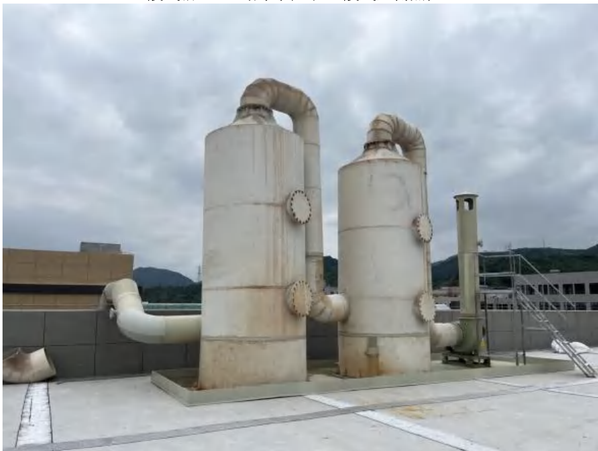
废气治理设施
