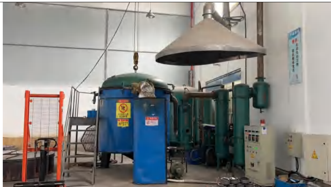
浸漆及废气收集设施
