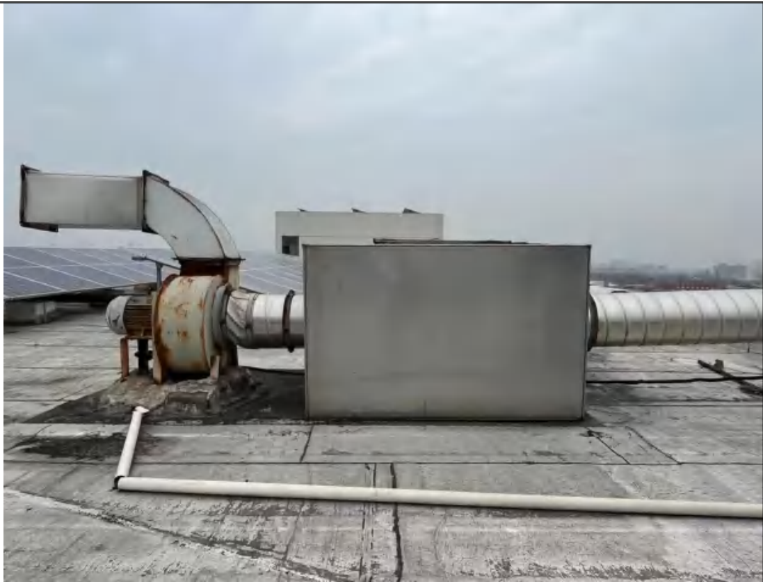
浸漆+焊接+自动喷漆废气处理设施（活性炭吸附）
