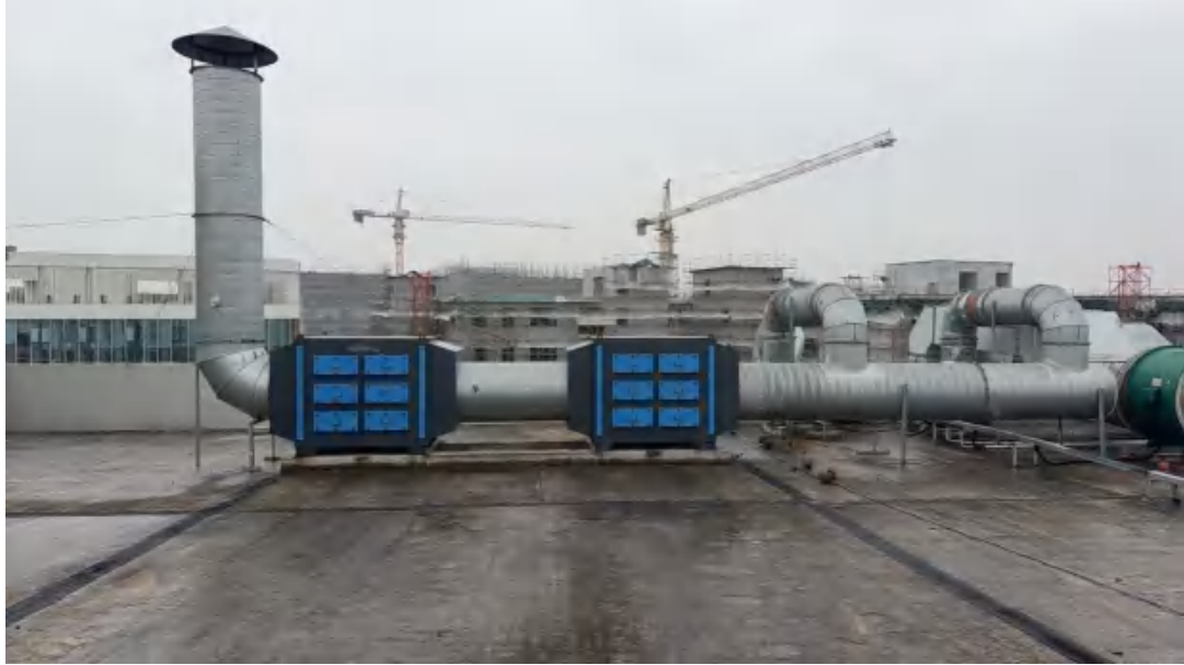
点胶废气活性炭吸附处理装置
