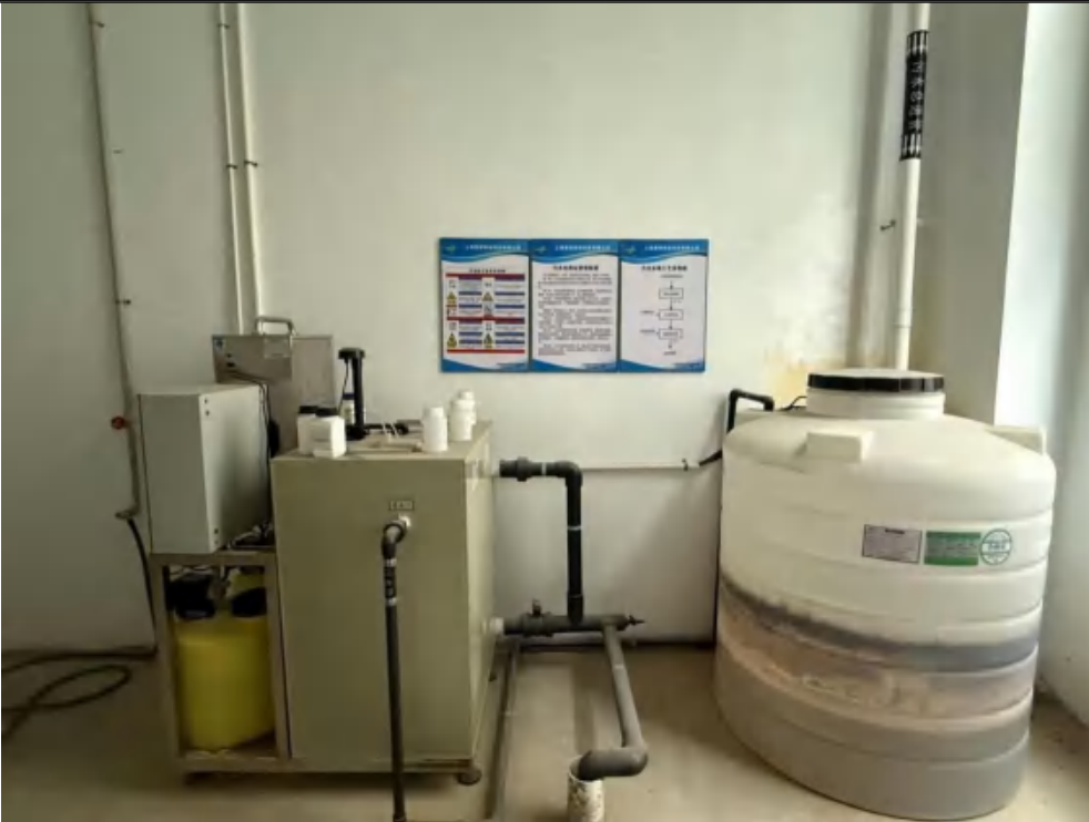
生产废水处理装置
