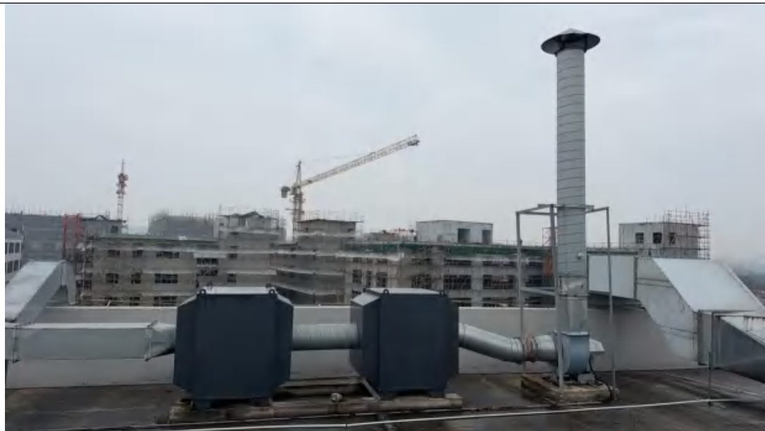
实验室废气活性炭吸附处理装置
